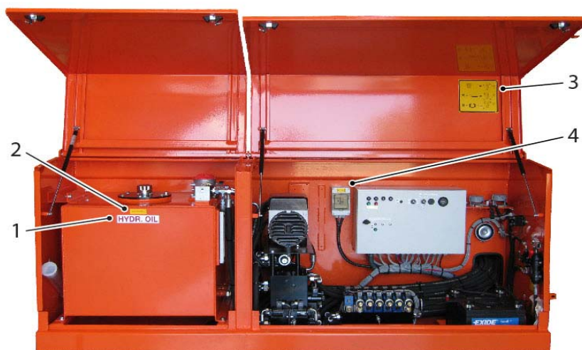
Compartiment d'huile hydraulique et compartiment des soupapes/électricité
