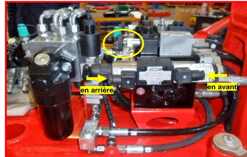
Figure 53 : vue du côté droit de la machine du distributeur principal.
