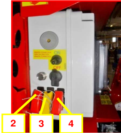
Figure 5 : côté gauche du boîtier électrique.
