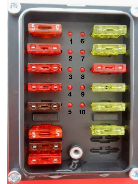
Figure 87 : boîtier de fusibles.
